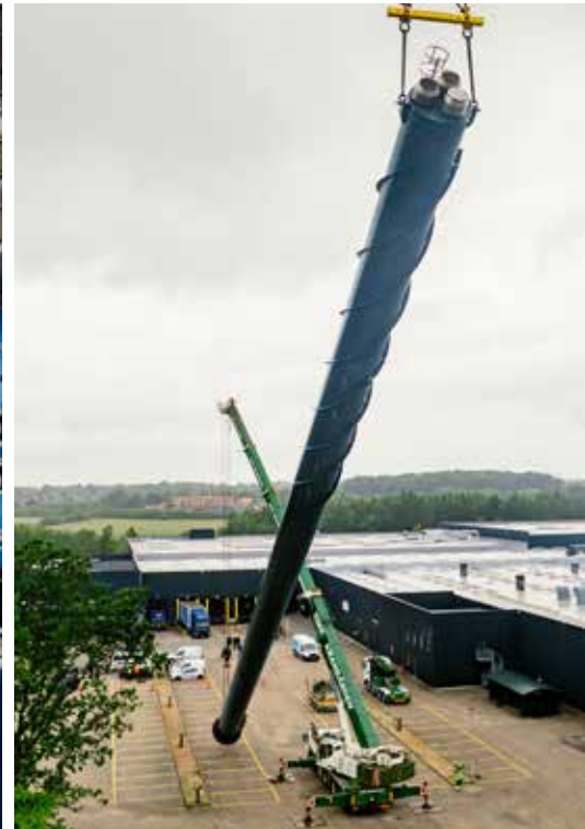
Efter omstillingen fra gas til el fjernede Ege Carpets den 63 meter høje skorsten på fabrikken i Herning.
